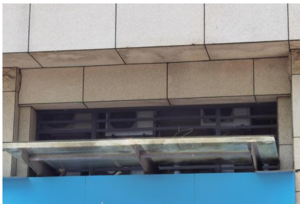
空调、换气系统排气口
